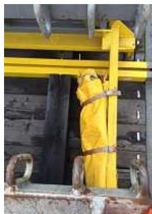
Richtig: Blache richtig gesichert
