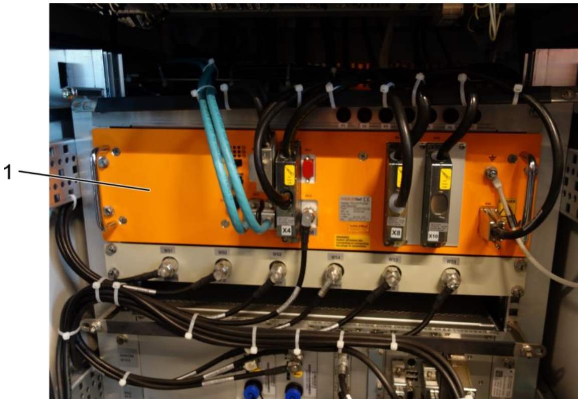
Abb. 39: Schaltschrank ETCS (+13a)
