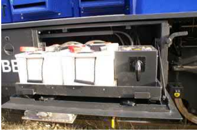
Grafik 1-34 Batteriekasten mit Batterie Hauptschalter
