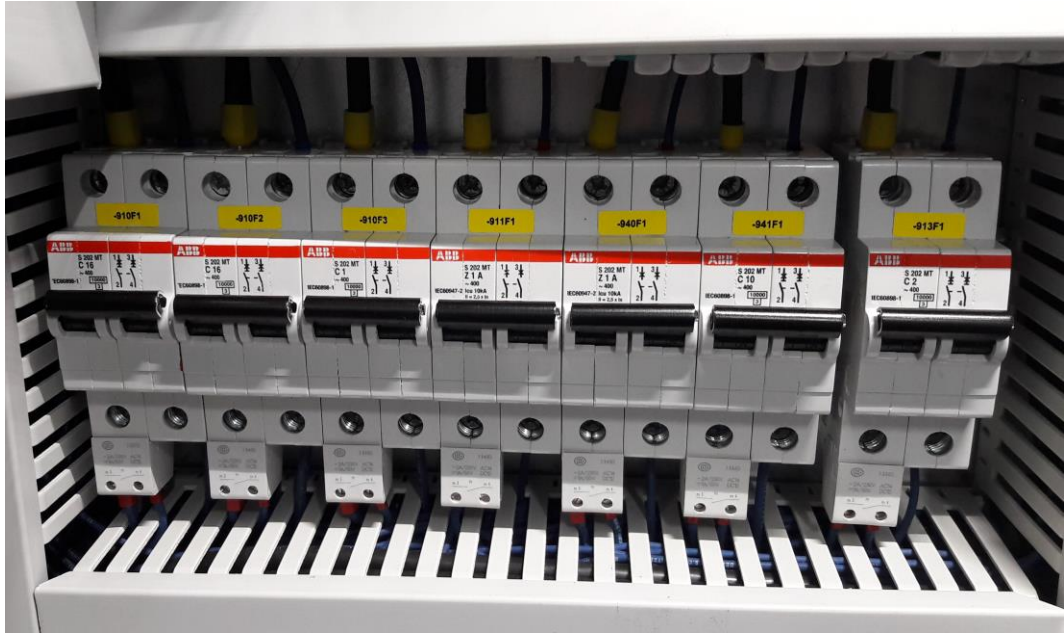
Bild 6 ETCS-Leitungsschutzschalter im Hauptschaltschrank +0-GS
