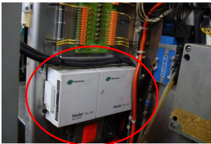
Geschwindigkeitsmessanlage mit Datenkassette auf Tafel „D“
